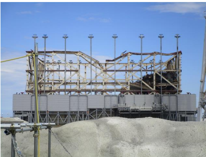
福島第一原子力発電所 1 号機建屋
