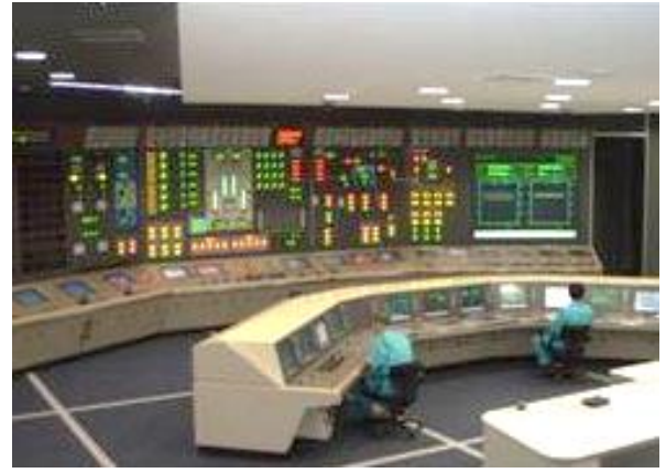
中央制御室。タッチパネルが並ぶ(中国電力HPより)
