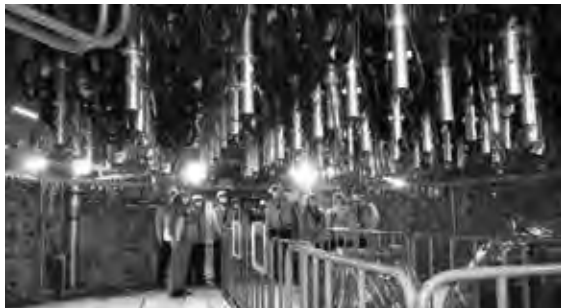
原子炉压力容器の真下で。銀色の筒には制御棒が納められ、多数のセンサーケーブルが見える(3年前視察時の写真)
